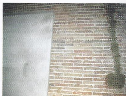
Regatas colmatadas con trozos de obra reciclados y mortero de cal
