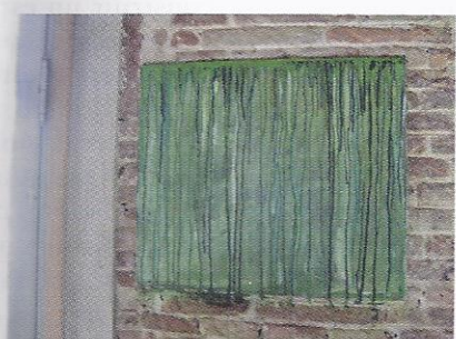
Cuadro sobre uno de los fragmentos de mortero de cal para regularizar los huecos de la obra vista
